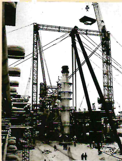
г. Березники, азотно-туковый завод. Первый крупнотоннажный агрегат аммиака. Подъем реактора с помощью портальной конструкции
