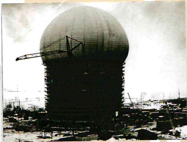
г. Пермь, ПО «Пермнефтеоргсинтез», изотермическое хранилище аммиака. Пнеumoопорная оболочка на изотермической емкости в период выполнения сварки внутренней емкости
