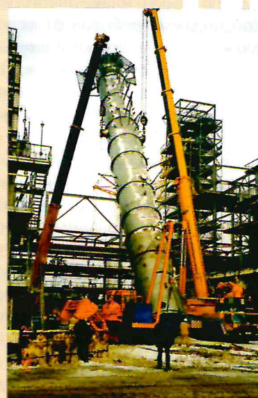
г. Пермь, ПО «Пермнефтеоргсинтез», комплекс глубокой переработки нефти, подъем колонны кранами грузоподъемностью 200 и 300 тонн
