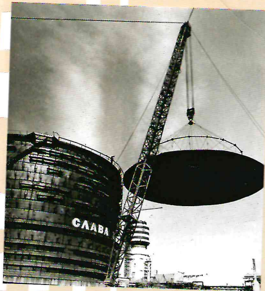
г. Пермь, ПО «Пермнефтеоргсинтез», изотермическое хранилище аммиака. Подъем наружной крыши мачтой с «парашютным» стропом
